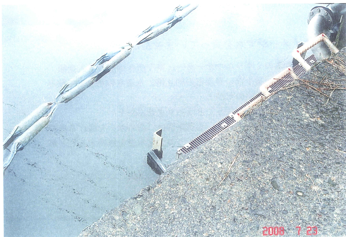
中屋敷取水口
